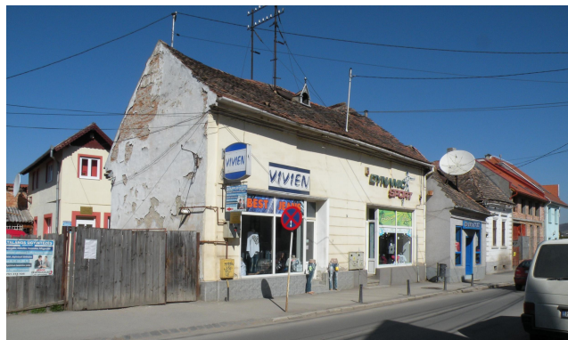
Jelenlegi állapot. A homlokzat drasztikusan megváltozott, az épület eljellegtelenedett. Falkutatással bizonyos elemek még felderíthetők
